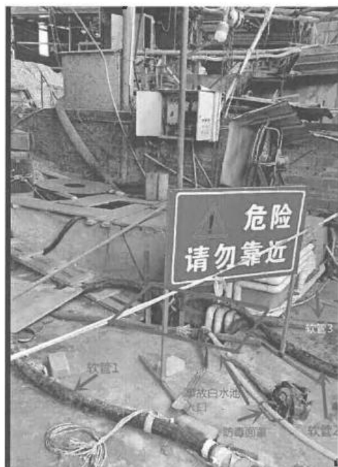
涉事白水收集沉淀池
